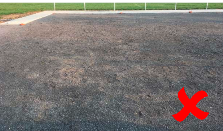
SO NICHT: Schotter uneben / nicht ausreichend verdichtet.
