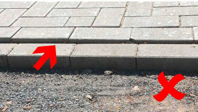
SO NICHT: Pflastersteine nicht höhengleich mit Randstein.
