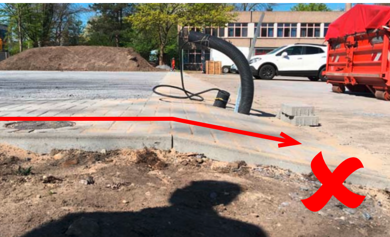
SO NICHT: Umlaufende Pflasterung abschüssig.
