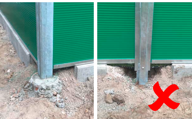
SO NICHT: Randstein nicht bis an das Leerrohr heran gebaut.
