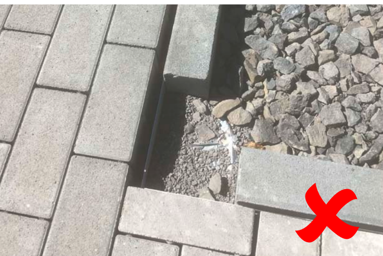
SO NICHT: Zu kleine oder verdeckte Fundament-Leerrohre.
