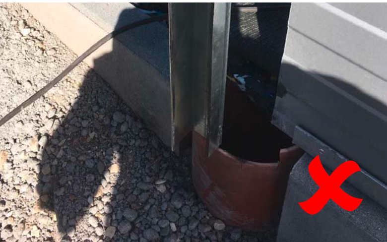
SO NICHT: Fundamente / Leerrohre falsch platziert.
