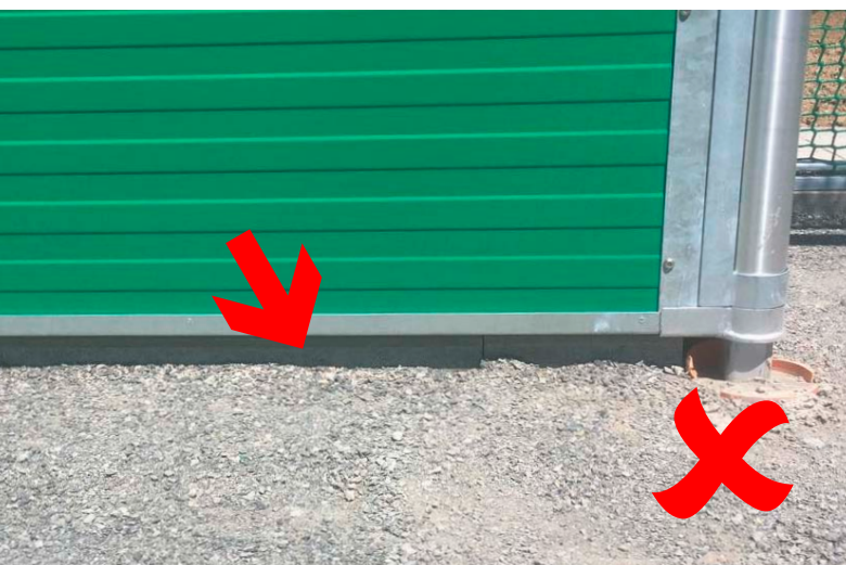
SO NICHT: Randstein nicht richtig platziert (hier zu weit außen).
