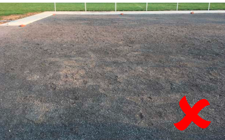
SO NICHT: Schotter uneben / nicht ausreichend verdichtet.
