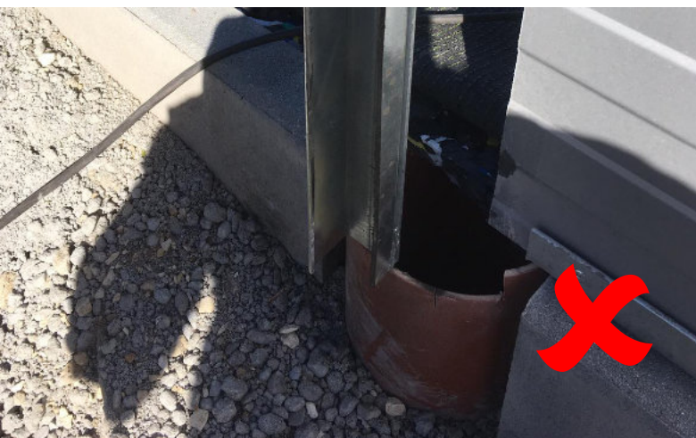
SO NICHT: Fundamente / Leerrohre falsch platziert.
