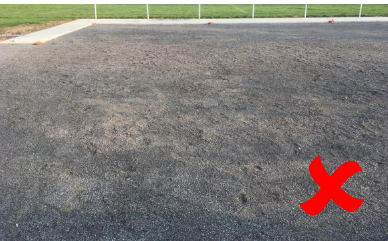
SO NICHT: Schotter uneben / nicht ausreichend verdichtet.
