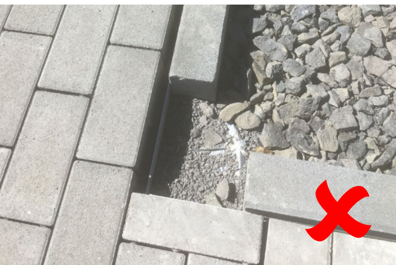
SO NICHT: Zu kleine oder verdeckte Fundament-Leerrohre.
