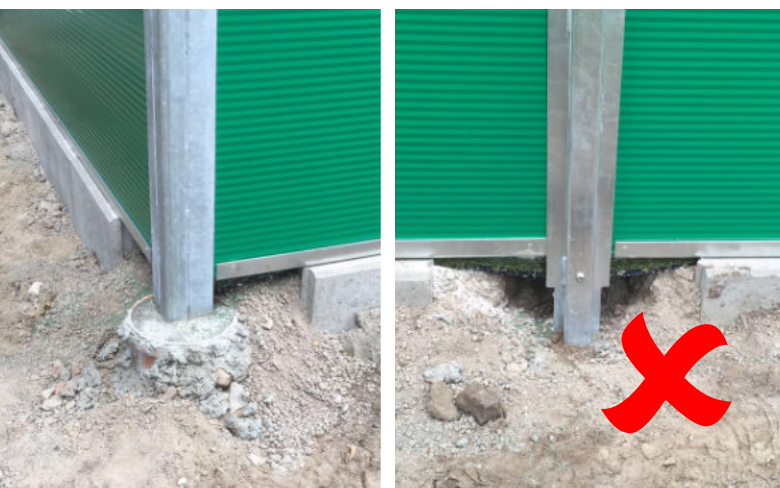
SO NICHT: Randstein nicht bis an das Leerrohr heran gebaut.
